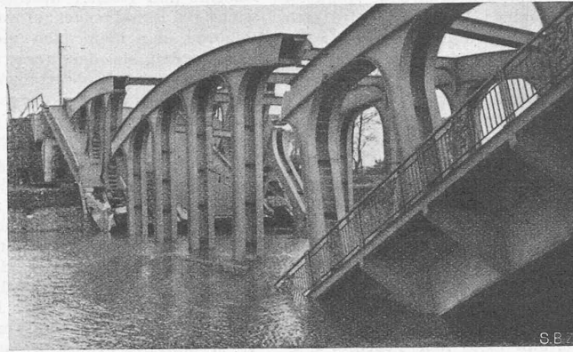
Abb. 3. Ansicht der eingestürzten Brücke gegen Westen
