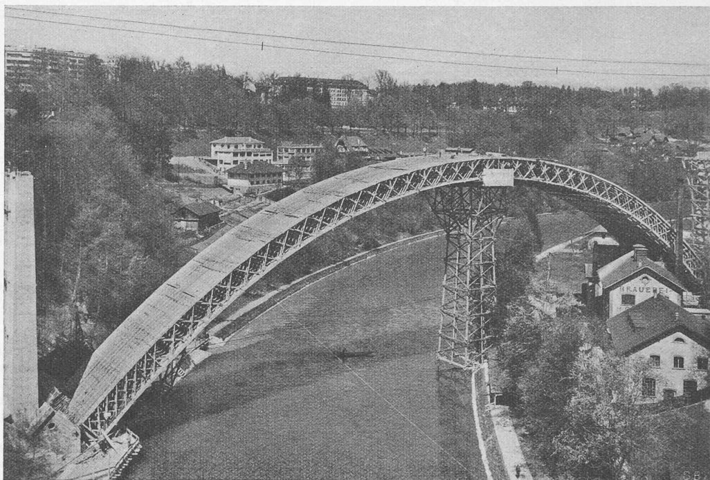
Lehrgerüst der neuen SBB-Aarebrücke in Bern. Stützweite 146,5 m. Erbauer LOCHER & CIE., Zürich Der Gerüstturm in der Mitte diente lediglich zur Montage und ist heute abgebrochen
