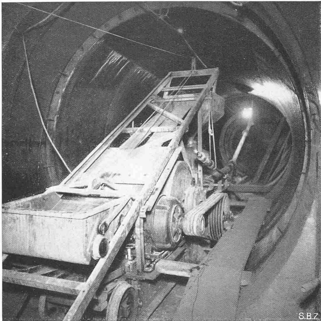
Abb. 13. Betonpumpe, links der Betonaufzugkübel, der in den Einfülltrichter der Pumpe (Hintergrund) kippt. Unter dem Aufzuggeleise der 30 PS-Antriebmotor der Pumpe, die bis 7 m 3 /h in die abgehende Leitung fördert
