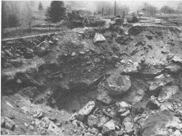
Abb. 1. Tagbruch-Trichter über dem Umlauf-Tunnel
