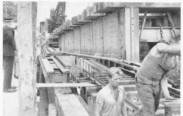
Abb. 7. Längsverschieben des angehobenen Ueberbaues einer Oeffnung, vorne am Kran hängend, hinten mit einem Querträger auf dem Zwillingssträger gleitend
