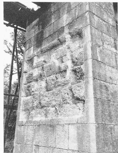
Abb. 3. Ausbrüche im Mauerwerk eines Zwischenpfeilers zur Verankerung des neuen Gewölbes
