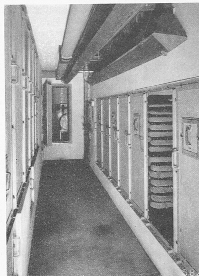
Bild 10. Bedienungsgang mit Luftkühler im Obergeschoss, rechts ein Feld der Verschalung offen
