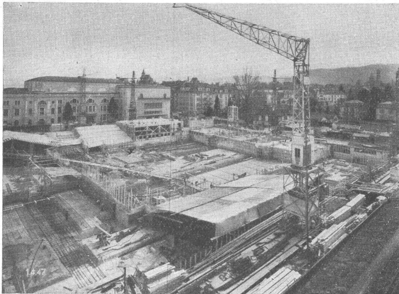
Geschäftshaus Claridenhof Zürich - Grundwasserisolierung Haus 2, 3, 4 u. 5 ca. 3200 m 2 Bauleitung: W. Henauer, Architekt, Zürich
