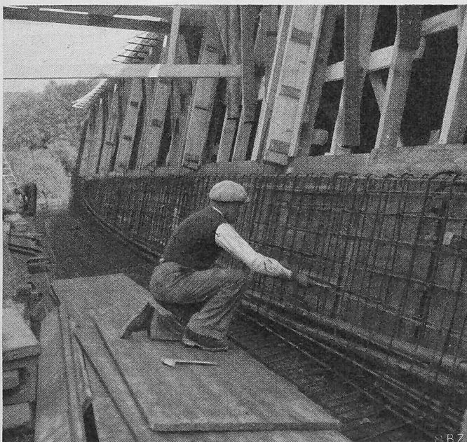
Bild 28. Weberei Boller, Winkler & Cie. in Turbenthal. Schalenshed mit 30 m Spannweite, Vorspannung der Fensterträger mit je 2 Kabeln zu 80 t. Projekt: Ing.-Bureau A. Sabathy, Winterthur.
