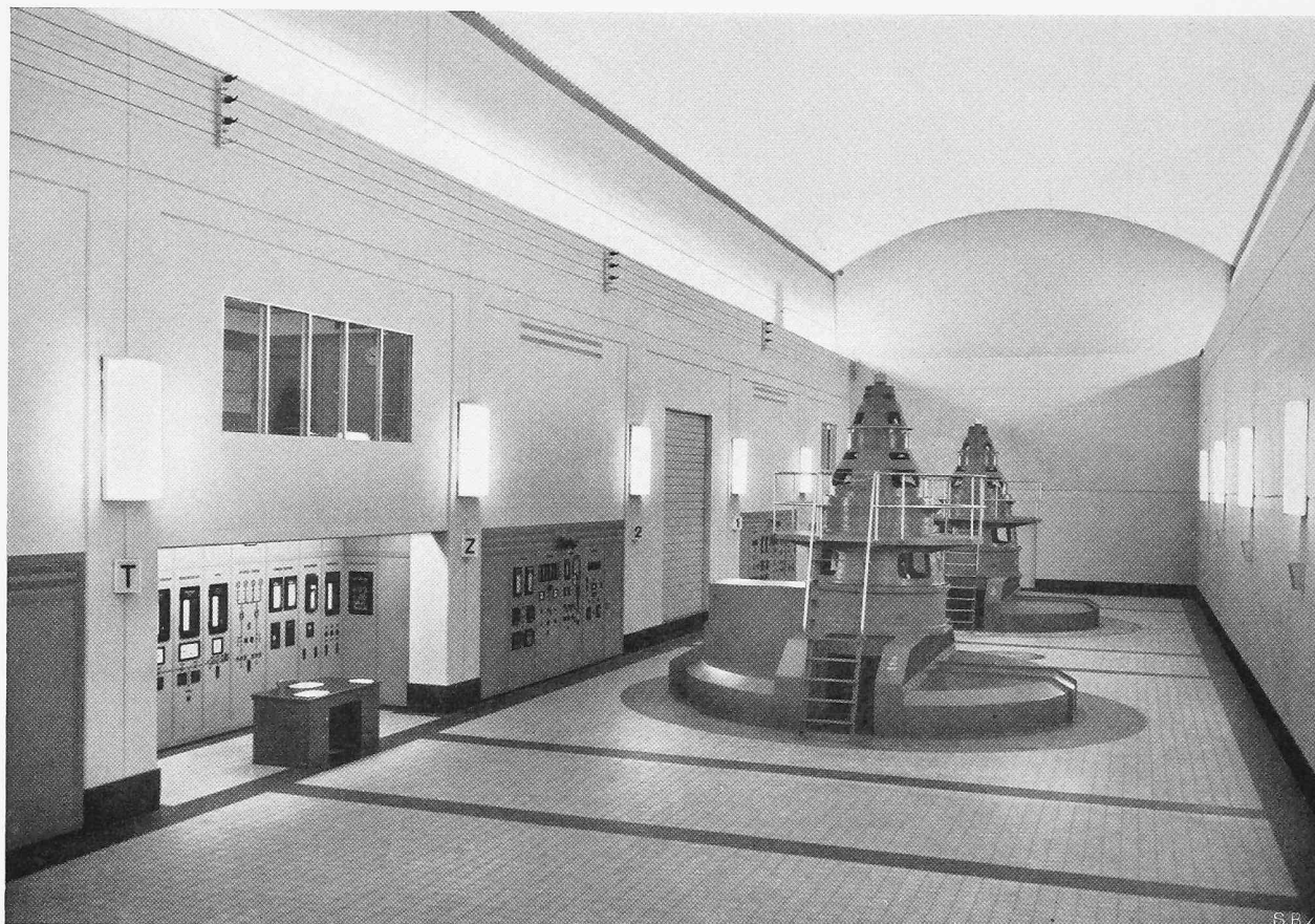
Zentrale Handeck II, Maschinensaal
