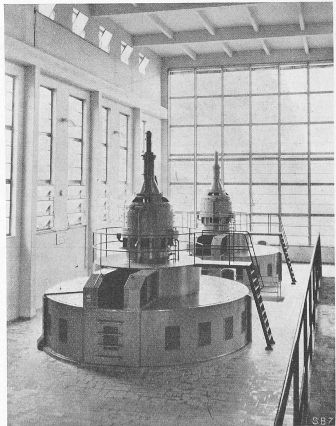
Bild 9. Maschinensaal mit den beiden Generatoren
