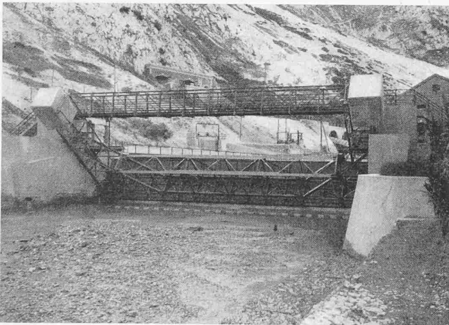
Bild 1. Hydraulisch-automatische Segmentschütze in Pescara. Fachwerkkonstruktion
