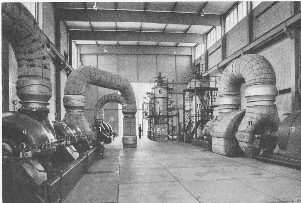
Bild 2. Die Gasturbinenanlage Weinfelden. Legende siehe Bild 1
