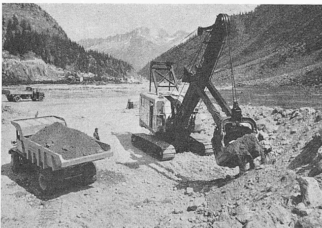
Bild 1. Bagger P&H 1055, 318 PS, 90 t, Löffel 2,7 m 3 . Links Rückwärtskipper 31 TD, 300 PS, beladen 40 t, Mulde 12 m 3
