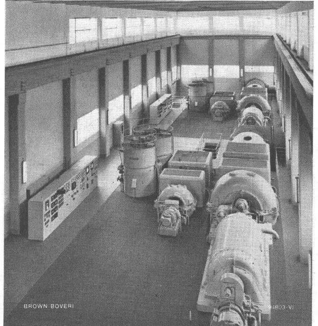
Bild 1. Die Gasturbinenzentrale in Livorno (Italien). Die beiden 25-MW-Gasturbinengruppen liefern die Energie in das Ueberlandnetz der Toscana. Der thermische Klemmenwirkungsgrad beträgt rund 25 Prozent. Die Maschinen werden gewöhnlich in 18 bis 20 Minuten auf Vollast gebracht. Dieser Maschinentyp ist besonders für Spitzen- und Notstromzentralen geeignet
