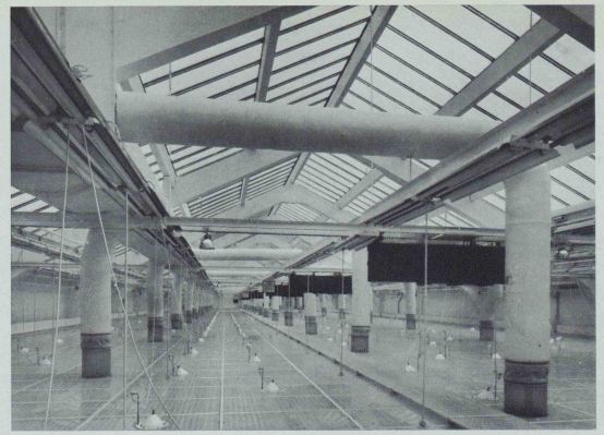
Dachraum mit Beleuchtungs- und Belüftungs-Installation; unten Ausstellungssaal
