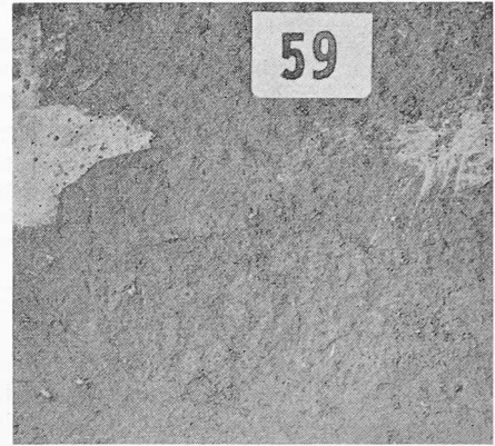
Nr. 59: Schalung Pavatexplatte, unbehandelt. Haftung des ZS mässig
