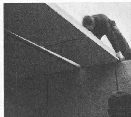
Ein Dachelement, ein Kastenträger auf der Unterseite mit Homogenplatten verschalt, wird aufgesetzt
