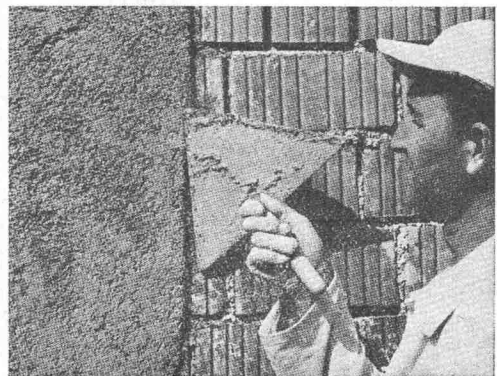
Putzmörtel ohne TRICOSAL-WA lässt sich nur mit Mühe zu einem zufriedenstellenden Putz verarbeiten.
