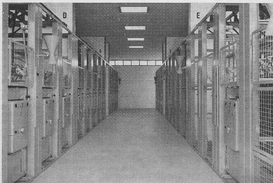
Bild 6. 10 kV-Betriebsenergieverteilanlage im Unterwerk II
