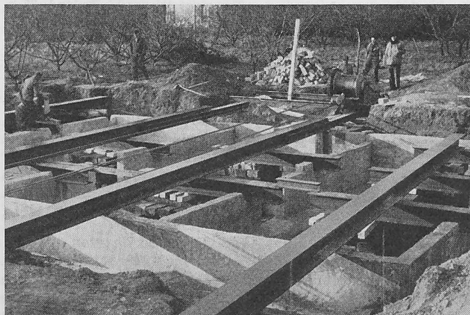
Bild 3. Die Schienen-Rollenbahn mit den neuen Keller-Fundamenten. Im Hintergrund die 5-t-Seilwinde mit Elektromotor
