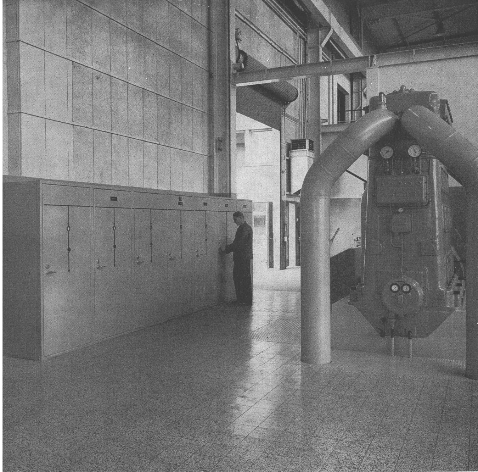
▲ 10-kV-Innenraum-Blockstation für Kompressorenanlage Gebr. Sulzer AG., Oberwinterthur
