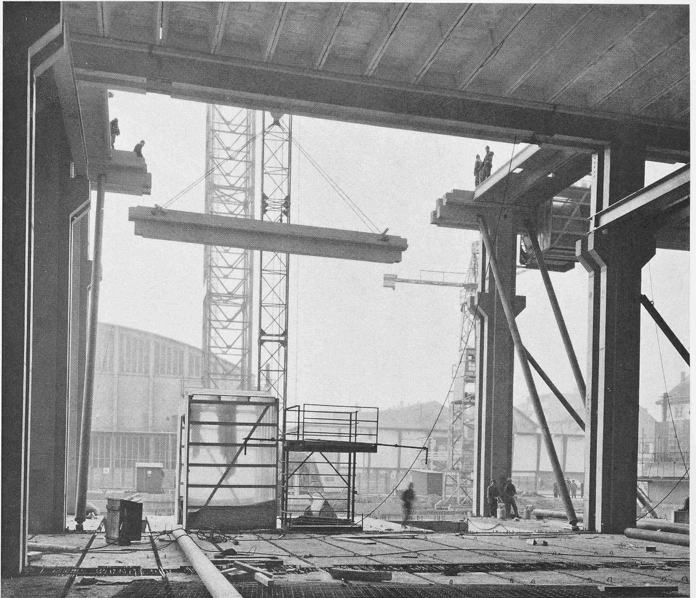
Blick vom Erdgeschoss aus auf das Einhängen eines Unterzuges auf die Stützenkonsolen. Die sichtbaren Siederohre dienen zum Richten der Stützen und als Verband bis zur Verbindung der Rahmen durch die Rippenplatten. Foto Hoffmann, Basel
