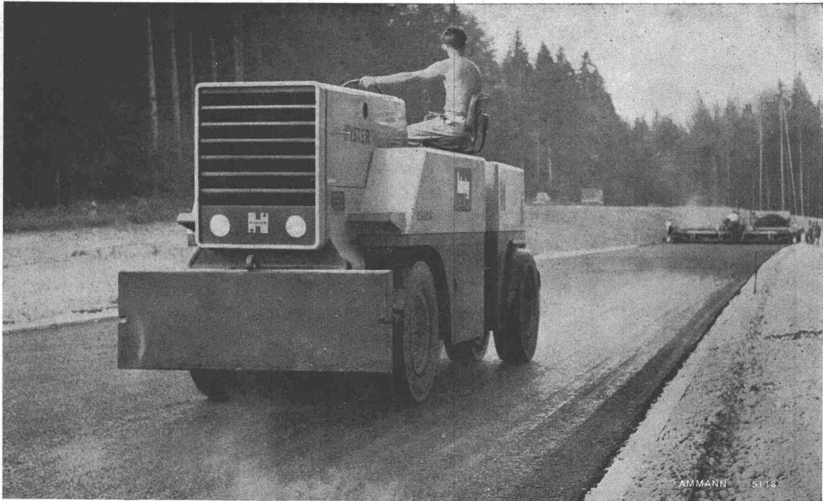
Tragschichtverdichtung auf der N 1 bei Hindelbank mit der HYSTER-Pneuwalze Modell C 500 A
