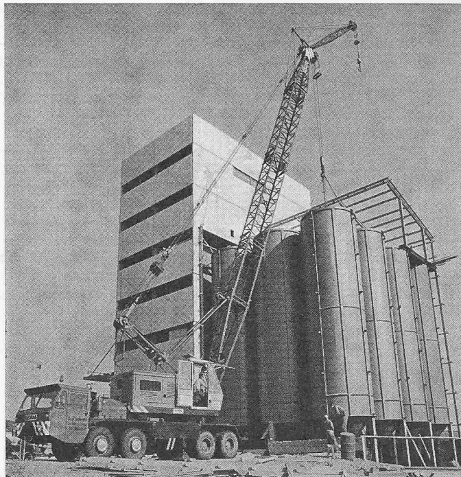
Bild 1. Getreide-Trocknungsanlage bei der SBB-Station Thalheim
