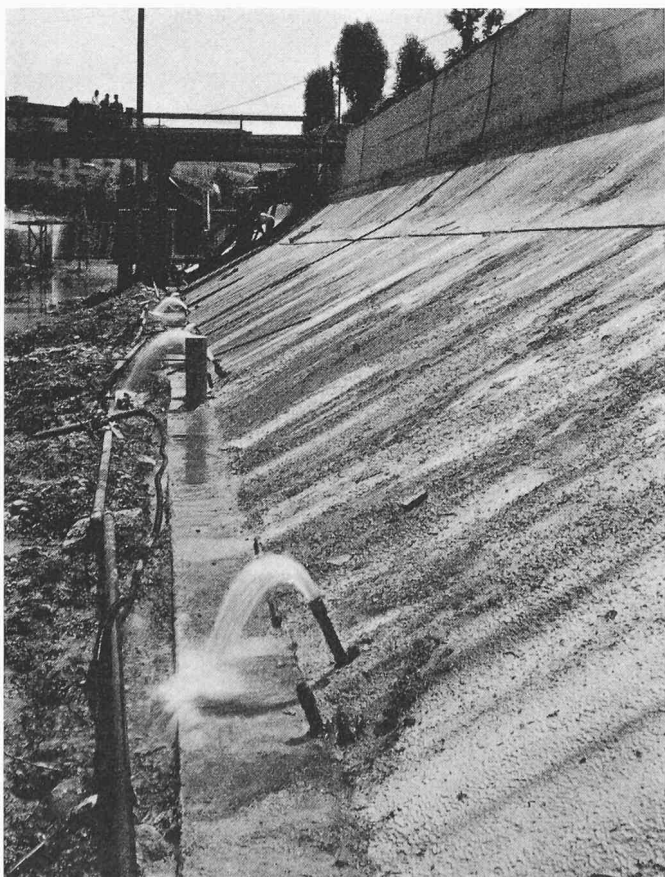
Bild 3. Wasseraustritte im Kanal des Kraftwerks Letten vor der Behandlung mit Injektionen
