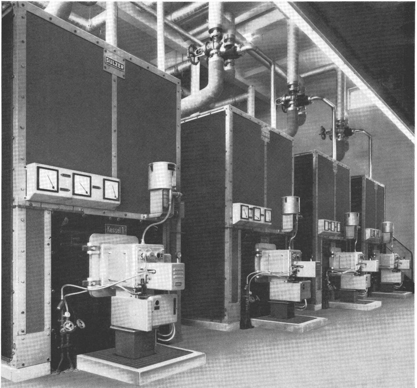
Heißwasser-Röhrenkessel, bestehend aus vier Einheiten zu je 1,6 Millionen kcal/h, Druck 15 atü
