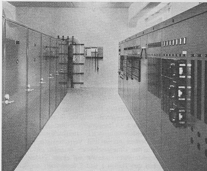
Bild 2. 10-kV-Hauptverteilung der Schmiede mit Niederspannungsverteilung im Untergeschoss der Halle 1
