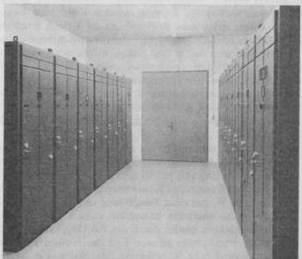
Bild 16. 10-kV-Hochspannungsverteilung in einem Nebenraum der Kältezentrale
