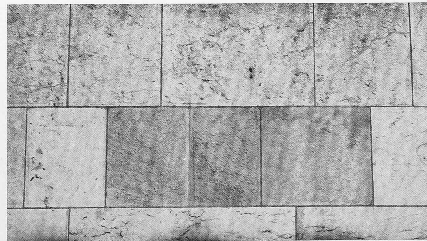
Bild 6. Rostbraun verfärbte pyritreiche Marmorplatten an einer Fassade aus hellgrauen Kalksteinen
