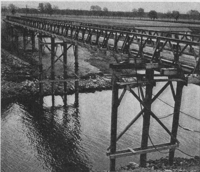
Dienstbrücke La Sauge, im Auftrag der Unternehmung AG Conrad Zschokke, Zürich, während dem Bau der neuen Brücke über die Ziehl. Belastung 16 t. Spannweiten: 3 × 21,35 m und 1 × 12,20 m, Fahrbahn 3,20 m, Auflagerung auf Pfahljochen. Zwei Hauptträger aus Bailey-Elementen und Holzbelag, Gesamtgewicht 35 t. Montage im Freivorschub ab Montagebühne, Zeitaufwand: 3 1/2 h/t.
