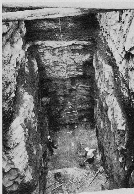
Bild 12. Spanngewichtsschacht im Fels der Station Birg
