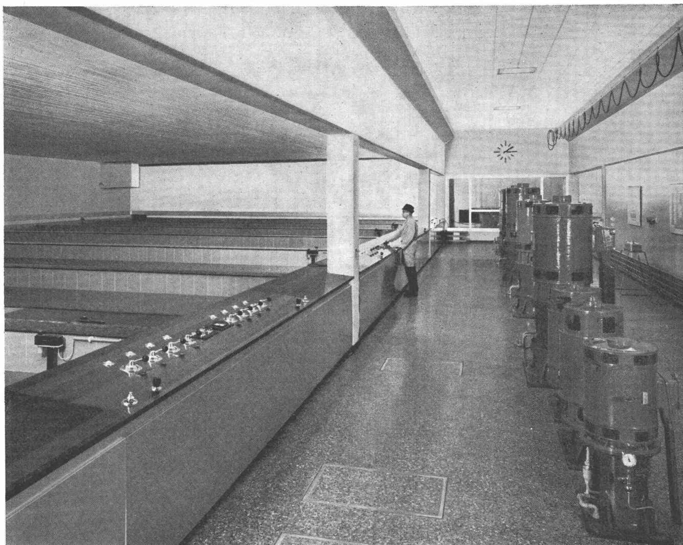
Schnellfilteranlage «Champ-Bougin» der Stadt Neuenburg mit einer stündlichen Leistung von 1800 m 3 . Rechts die Antriebsmotoren für die Pumpen
