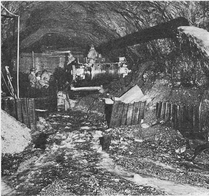
Bild 13. Druckstollen Sampuoir. Situation im Stollen nach dem Material-einbruch aus der Kluft bei Stollenmeter 1492.50. Eine Betonmauer wird vor dem zugeschütteten Bagger Conway 100 erstellt. Wasserandrang 130 l/sec
