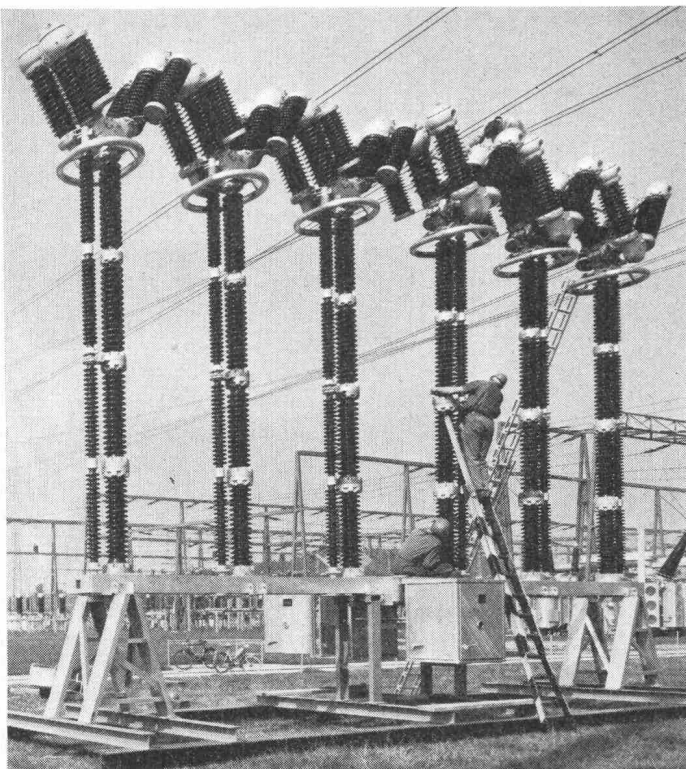
Bild 1. Ölarmier 765-kV-Schalter mit Mehrfachunterbrechung
