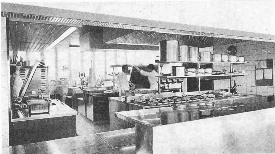
Die Küche neben dem Personalrestaurant im Attikageschoss. Ein Warenlift verbindet sie mit den Kühl- und Lagerräumen im ersten Untergeschoss
