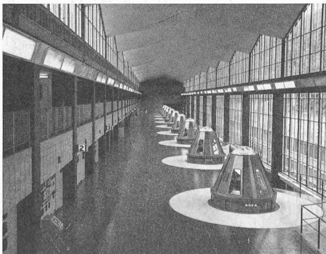
Bild 12. Blick in die Maschinenanlage des Kraftwerkes Murray 1 mit zehn 95-MW-Turbosätzen mit Francis-Turbinen
