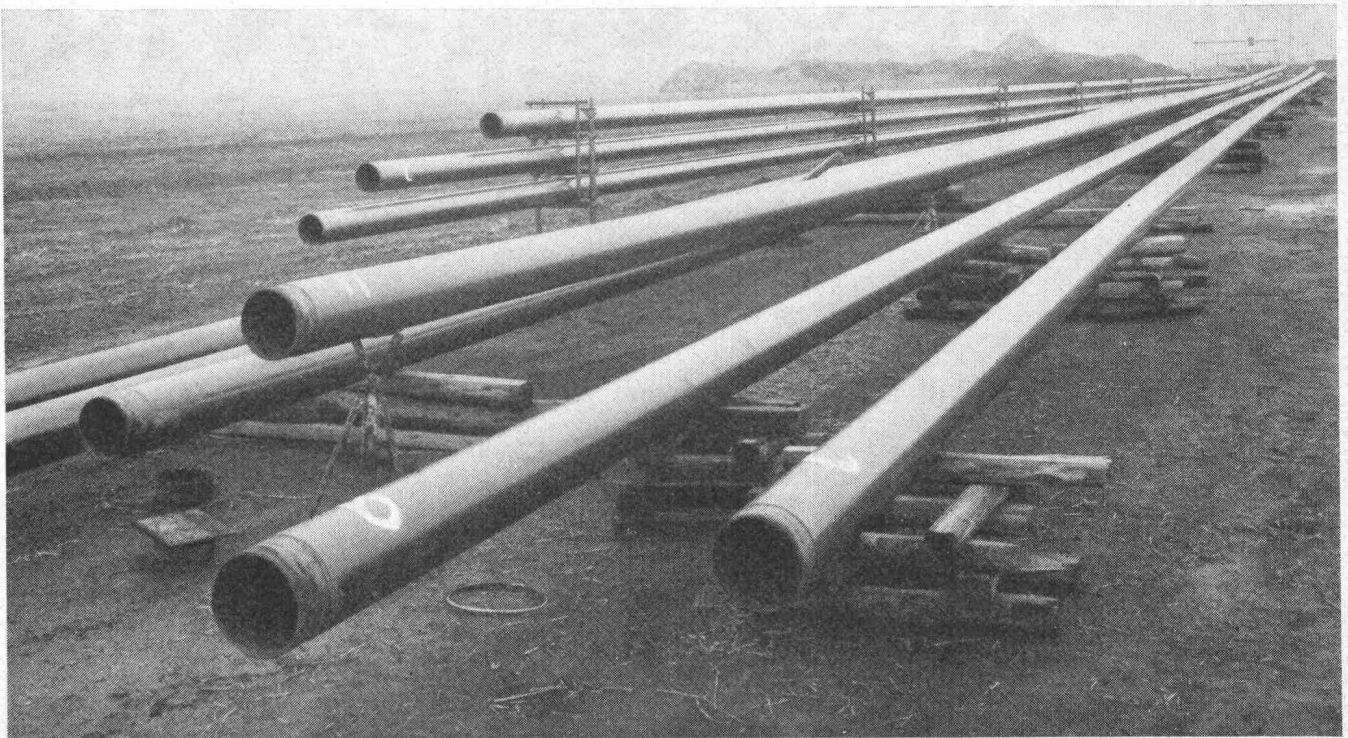
Das Foto zeigt zusammengeschweisste Rohrstränge aus kunststoffumhüllten Rohren für die Verlegung eines 3fach-Dükers.
