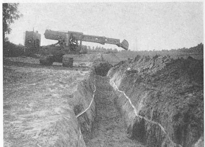
Bild 31. Eindecken des Grabens mit einem Gradall-Bagger. An den Grabenwänden sind in rund 50 cm Tiefe die Warnbänder angebracht
