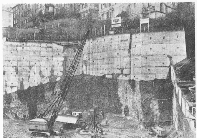
Bild 7. Teilweise permanent verankerte Baugrubenwand in St. Gallen. Im unteren Teil reichen die Anker bis in den anstehenden Felsen
