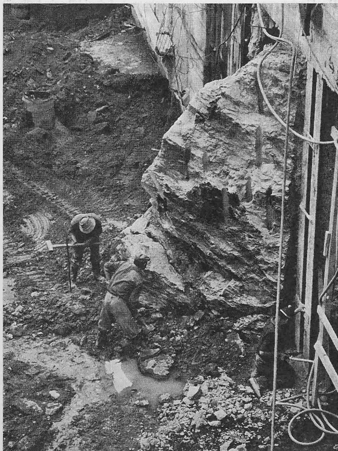
Bild 1. Abbau eines der grössten Findlinge in der Baugrube. Die Rühlwand musste wegen des Findlings unterbrochen werden
