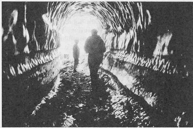
Bild 5. Der Eisstollen liegt wieder trocken da. Die Sohlenerosion von fast 1 m erfolgte in wenigen Tagen (19. 7. 71)
