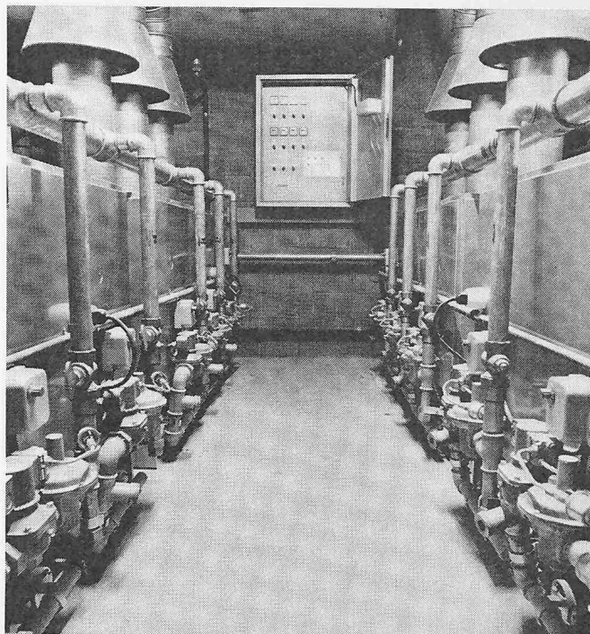
Bild 6. In der Gasheizzentrale des Geschäftshauses und Shopping Centers Biel befinden sich insgesamt 24 Gasheizzellen mit einer Gesamtleistung von 1,32 Mio kcal/h. In der Mitte der Steuerungskasten mit dem Betriebsstundenzähler der acht Kaskadenstufen (Photo Anag)
