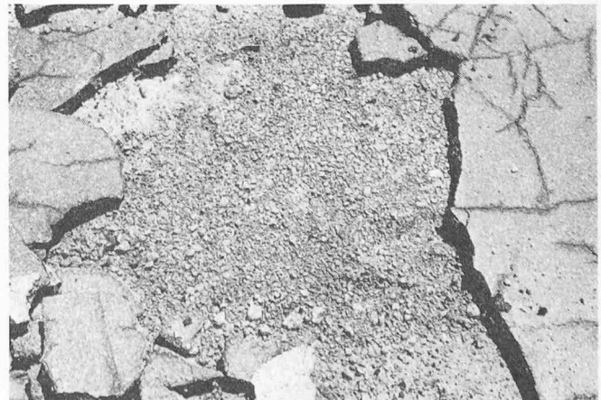
Bild 3. Aufgesprengter Belag. Die durch Frosteinwirkung begonnene Zerstörung wird durch die Verkehrsbelastung fortgesetzt
