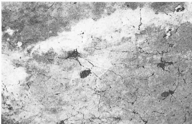
Bild 5. Brückenuntersicht mit Sinterungen und Frostschäden
