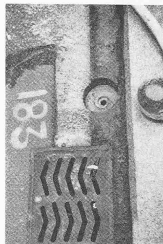
Bild 13. Die auf Bild 11 gezeichneten Bohrungen mit Durchmesser 25 mm, 40 mm und 150 mm sind in der Brückenoberfläche zu erkennen
