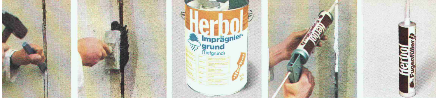
er Riß wird in Keilform erweitert, grundieren mit Herbol-Imprägniergrund
