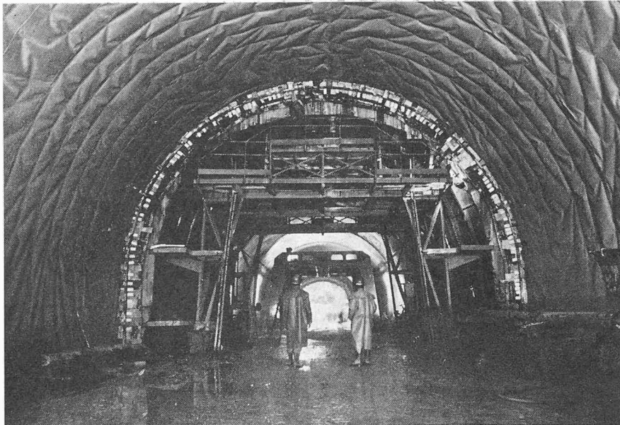
Bild 2. Gotthard-Strassentunnel. Schalung für den Auskleidungsbeton im Bereiche der isolierten Lockergesteinsstrecke beim Nordportal
