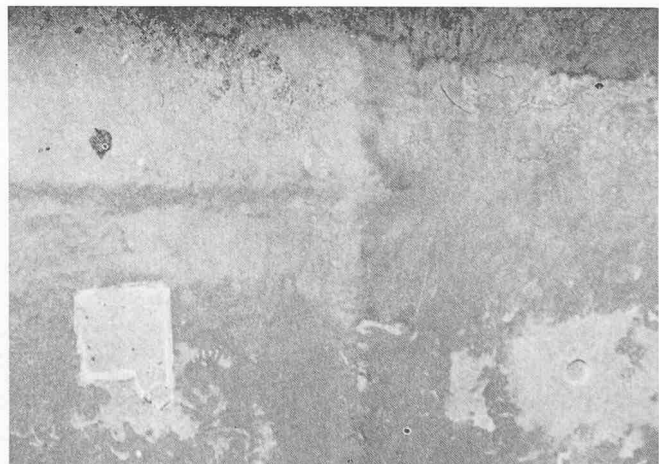
Bild 2. Vorzüglicher Zustand der Stahlunterlage nach dem Ablösen des Schutzsystems auf Epoxidharz-Polyester-Basis mit Glasarmierung nach vier Jahren Lagerung im Grundwasser
