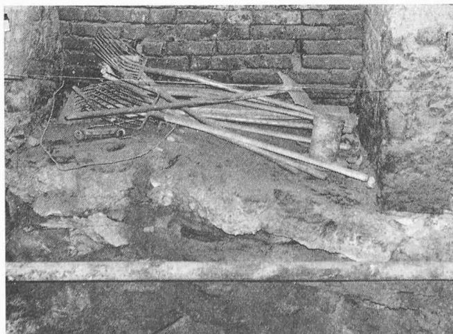
Bild 1. Sohlenhebung im Bereich einer Tunnelnische von etwa 2 m Breite; Anhydrit des Muschelkalkes (Bözbergtunnel, 1964)
