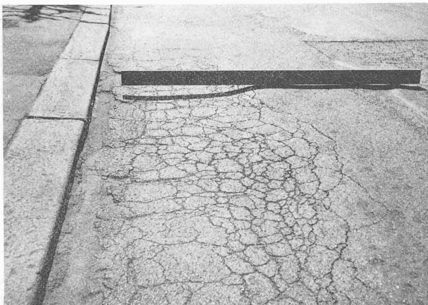
Bild 7. Stadtstrasse, Rillenbildung und Belagszerstörung.
