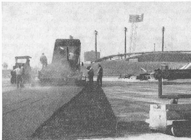
Olympiasee, München. Einbau des Asphaltes mit einem Fertiger über dem verlegten Structofors-Gewebe
