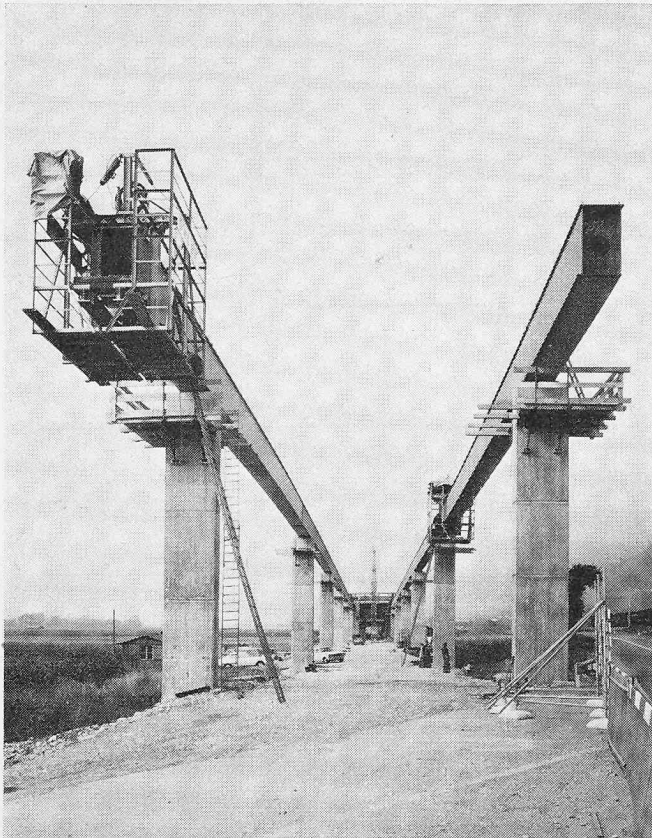
Viaduc du Landeron-Ouest , N. 5 Neuchâtel-Bienne. Passage en biais et en courbe au-dessus de la route cantonale et des voies CFF. Longueur totale de 590 m en 19 travées, dont 12 de 29,0 m, la plus longue ayant 56,0 m et la plus courte 22,0 m. Deux poutres métalliques en caisson de 0,75 m de largeur intérieure par 1,50 m de hauteur, écartées de 10 m, supportent une dalle commune aux deux sens de circulation de l'autoroute. La mise en place des éléments de poutres s'est faite à l'aide d'une grue, travée après travée, et non par lancement comme pour les autres ponts. Dalle en béton coulé sur place sur coffrages mobiles
